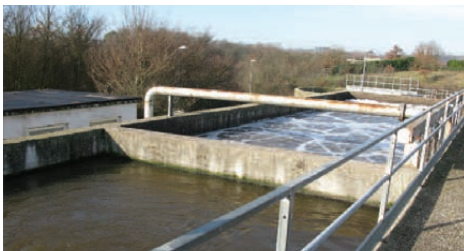
Il depuratore di Mazzano Romano in fase di funzionamento
